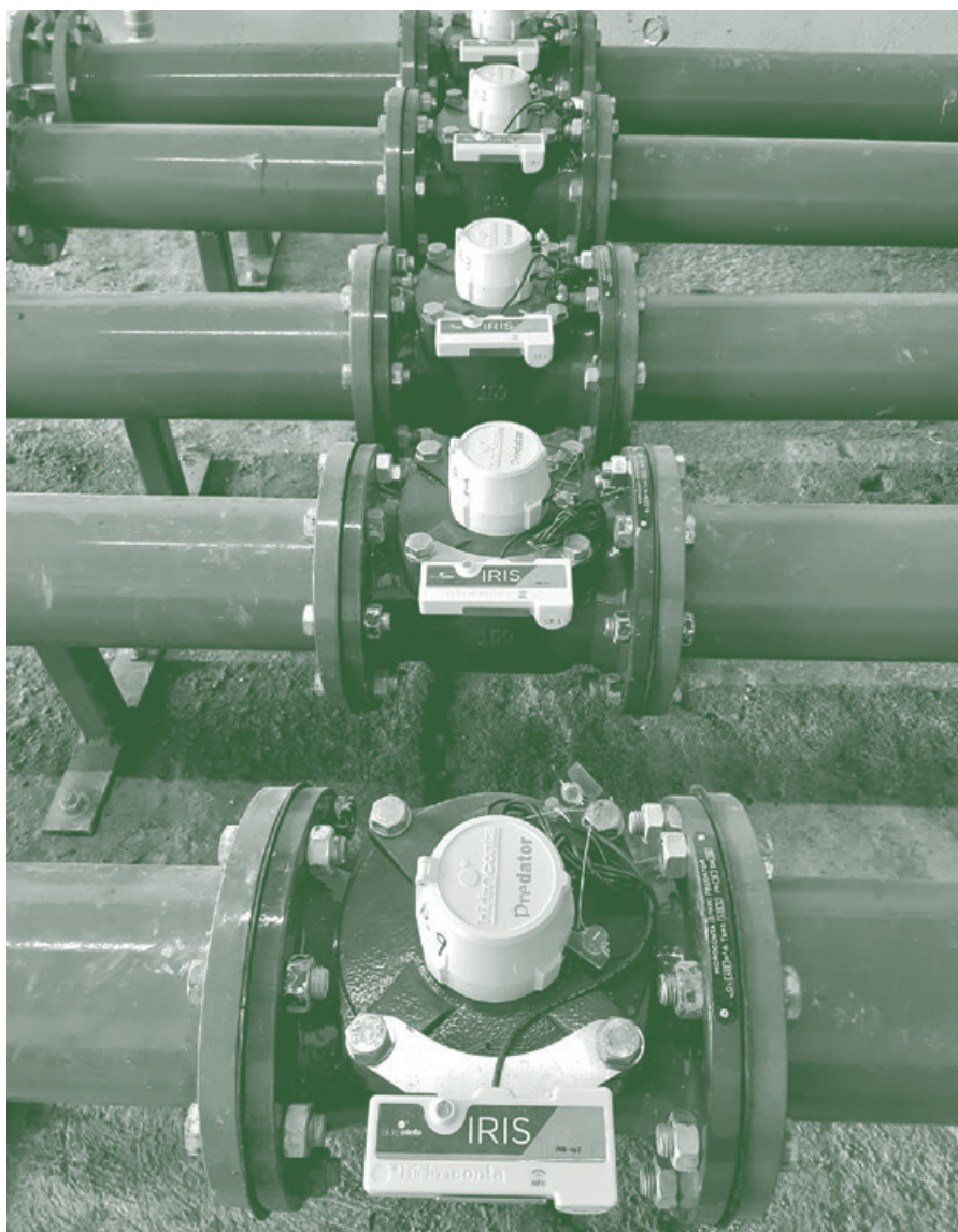
Medidores de água digitalizados com o Iris no distrito de Cota 400.
